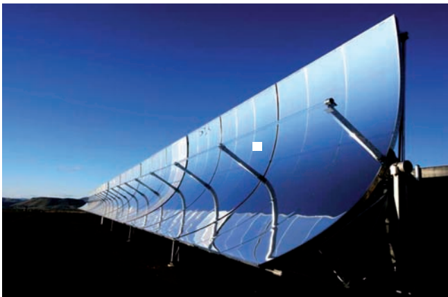
Miroir parabolique pour collecte de l'énergie solaire
